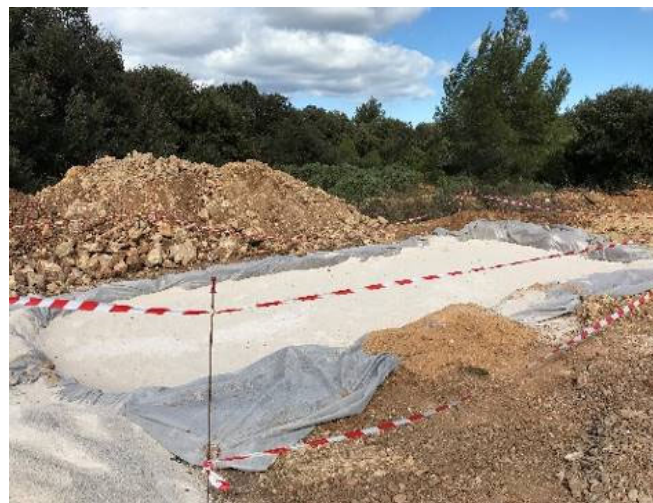
Figure 36 : Fouille préparée pour la pose d'un poste de conversion/transformation (Source : EDF Renouvelables)
